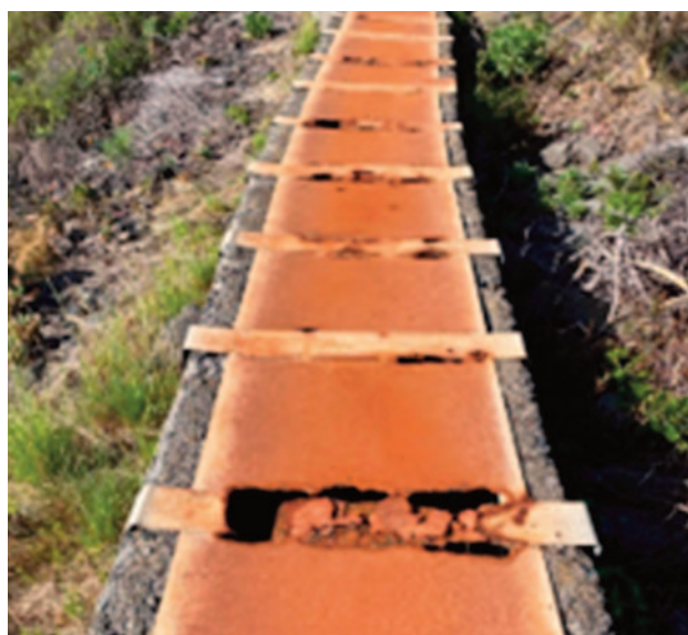
Detalles de tramos en mal estado del canal
